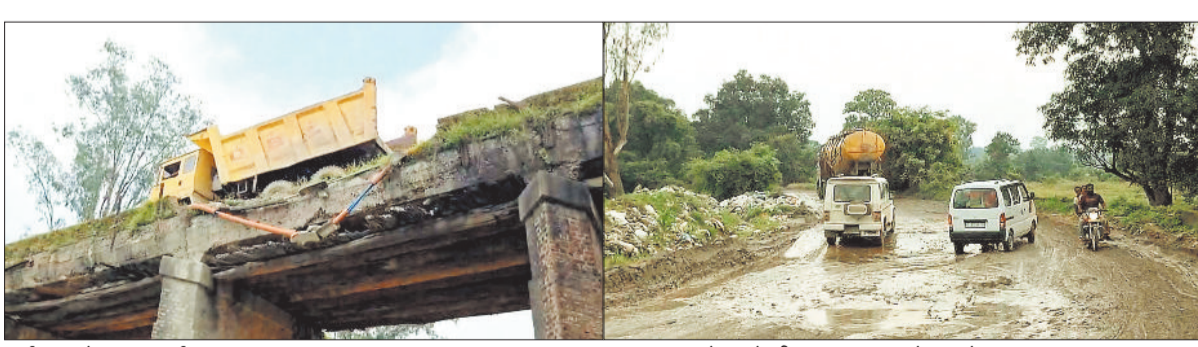
जर्जर पुल से गुजरता हाईवे।
